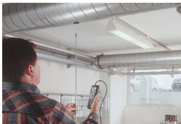
testo 425 při nastavování dodávaného vzduchu do kuchyně
