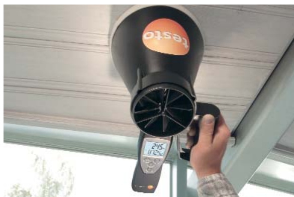
testo 417 při kontrole dodávaného vzduchu na talířové výústce
