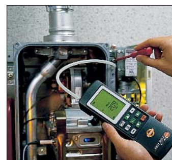
Měření diferenčního tlaku na kotli
