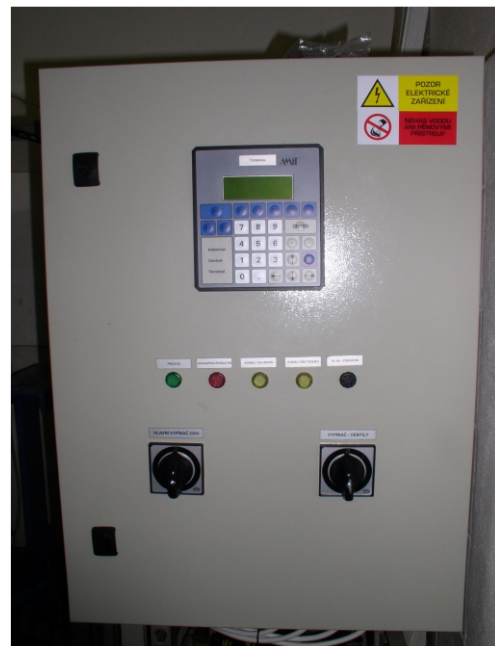
Шкаф распределителя KOR-1
