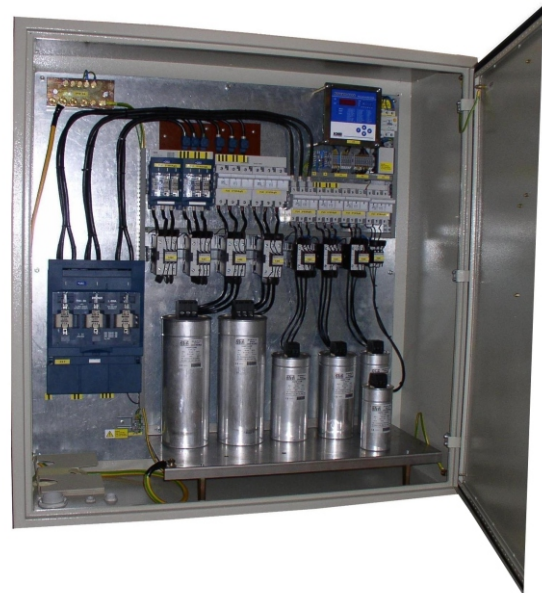
Szara rozdzielnicy KR1
