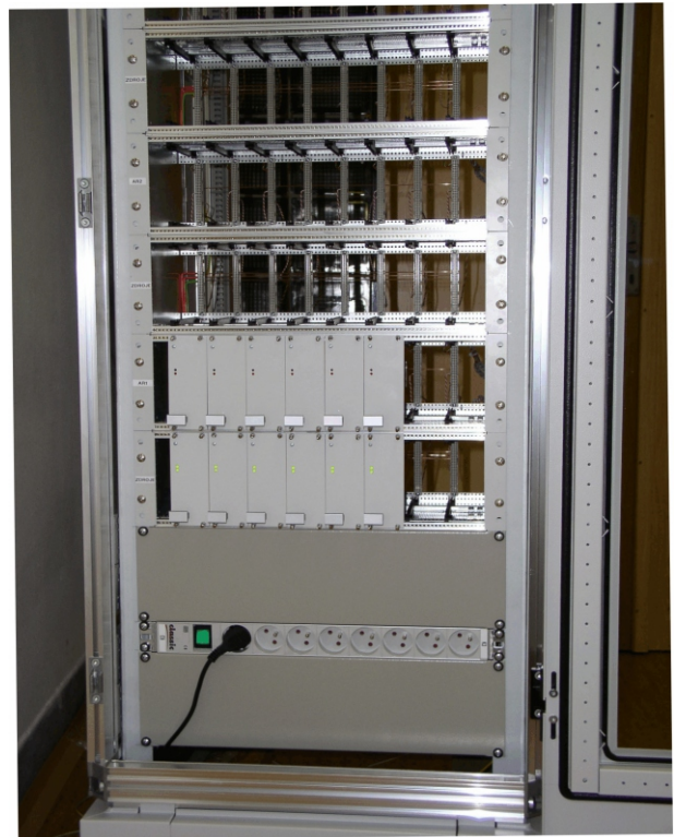
Povrchový rozvaděč SE-RM1 s 6 seismoakustickými deskami SAZ-T1 a 6 napájecími deskami SE-S1
