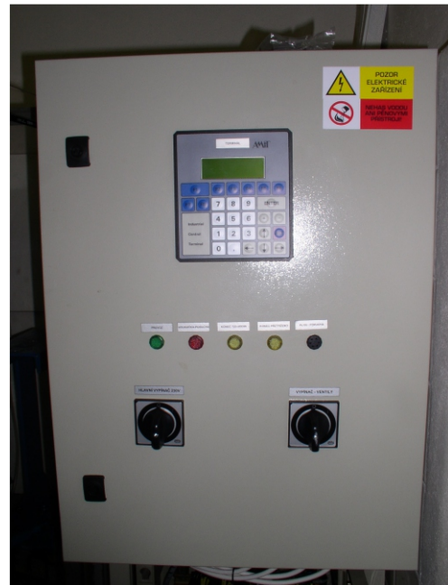
Rozvaděčová skříň KOR-1
